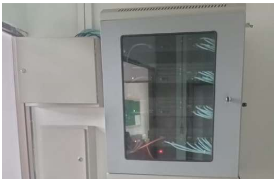
PRI and Intercom
